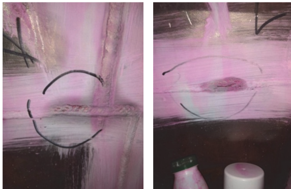
Рис. 5. Подтвержденные капиллярным методом дефекты
