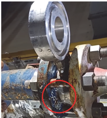
Рис. 5. Утечка на фланцевом соединении трубопровода водорода
