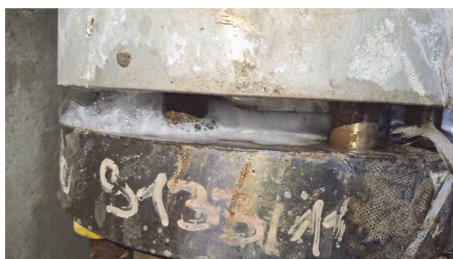
Рис. 6. Утечка на фланцевом соединении трубопровода продукта реактора
