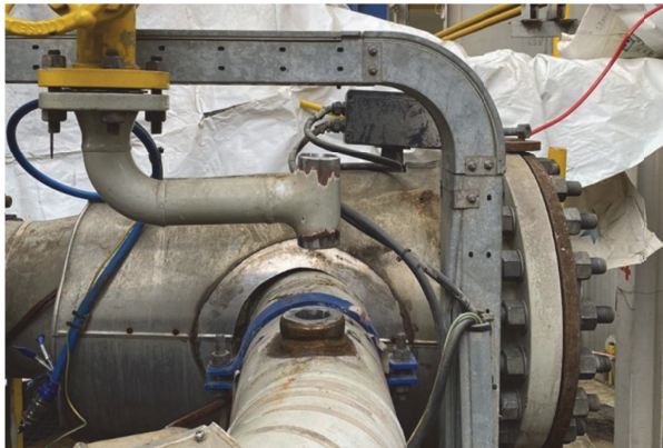
Рис. 12. Несоосность частей трубопровода блока КЦА, приведшая к возникновению дефекта
