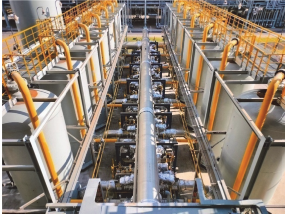
Рис. 9. Общий вид блока КЦА
